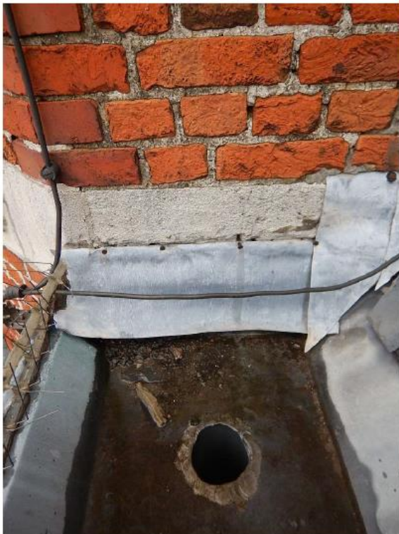
Goot west in aansluiting met toren (ref A)
